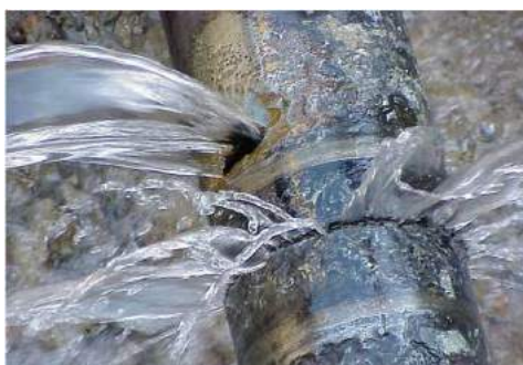
Рис. 4.30. Потери воды на магистральном водопроводе
